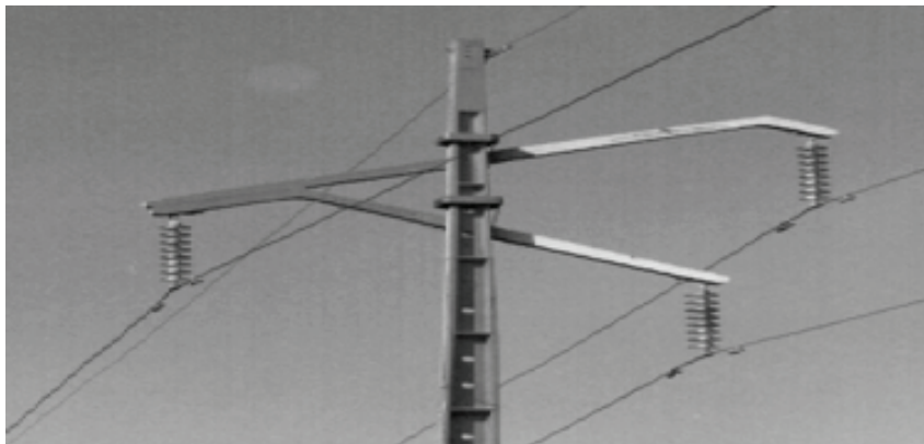
Figura 10.1 – Estrutura típica de linhas de transmissão em 69 kV.
