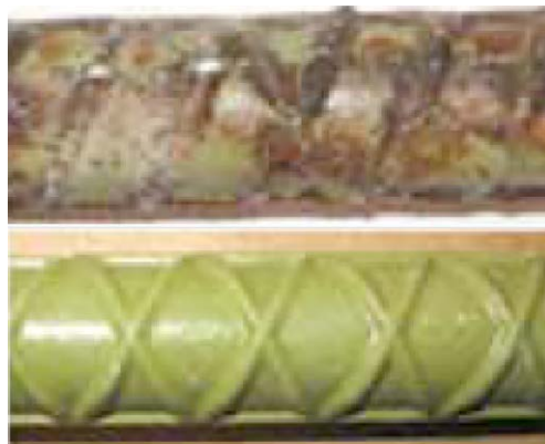
Figura 42 – Armaduras com pintura epóxi, com e sem corrosão
