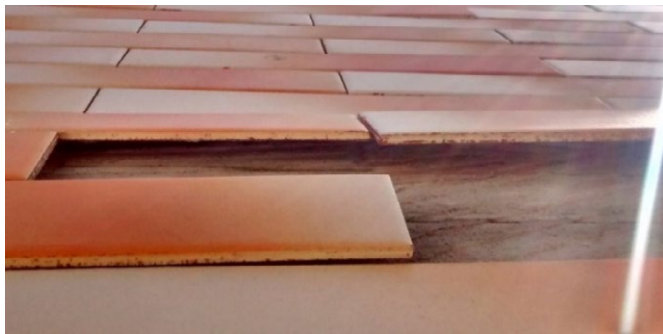
Figura 3: Placas cerâmicas parcialmente descoladas
