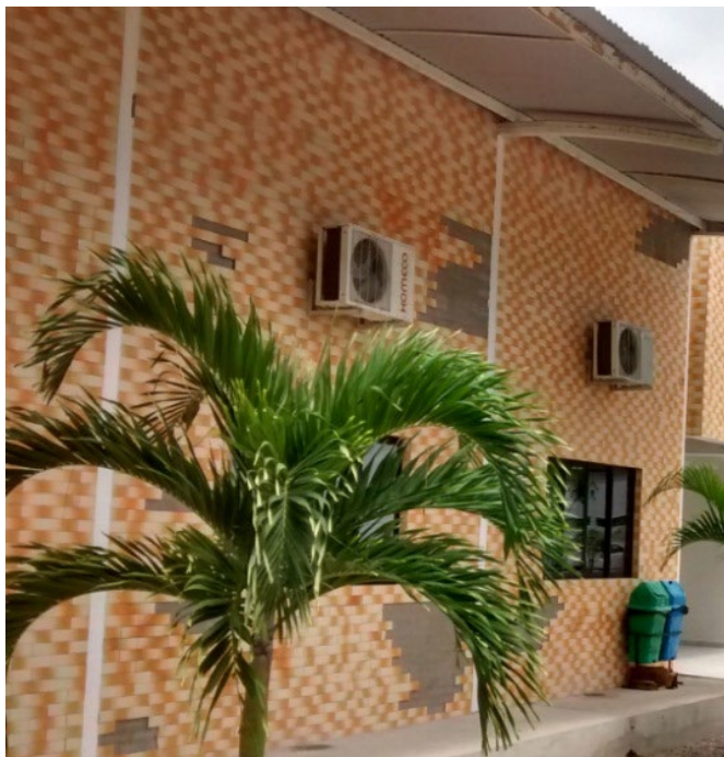
Figura 2: Fachada principal com descolamento do revestimento
