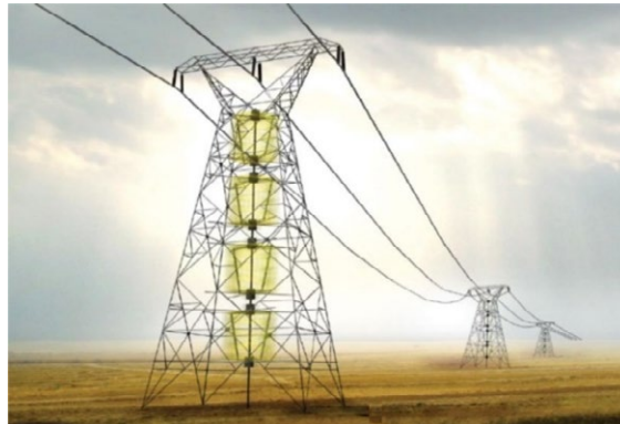
Figura 6.24 – Torre de transmissão trifásica
