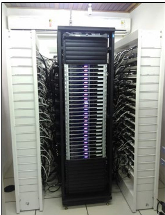
Figura 4 – Rack com 200 receptores DVB-C e 25 encoders de vídeo HDMI→TS/IP com 8 entradas cada um (esquerda); e racks com 28 servidores de alto desempenho e alta disponibilidade e storage com 3Pb para armazenamento de vídeo (direita).
