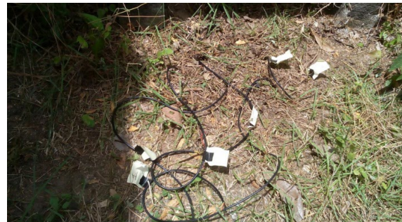
Figura 7 – Sensores instalados no solo
